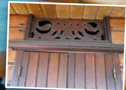
Ouvertures pour la ventilation naturelle
